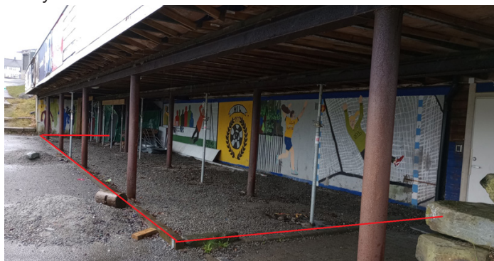
Arealet under den utette terrassen var ikke utnyttet. Bjelkene var rustet, midlertidige støtter var montert for å sikre terrassen.
